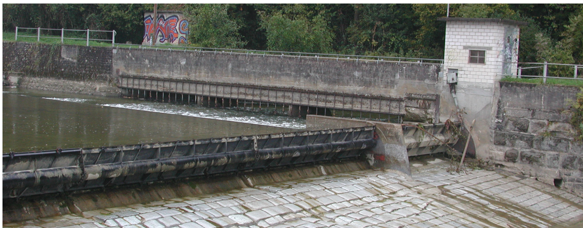
Stauwehr mit Einlaufrechen
