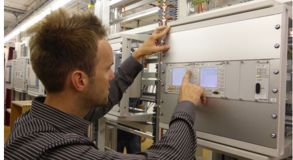
CKW-Netzschutzspezialist René Krummenacher bei der Inbetriebnahme des Spannungsreglers vom Transformator.
