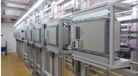
Die neuen Steuergeräte der Unterstation Schüpfheim.
