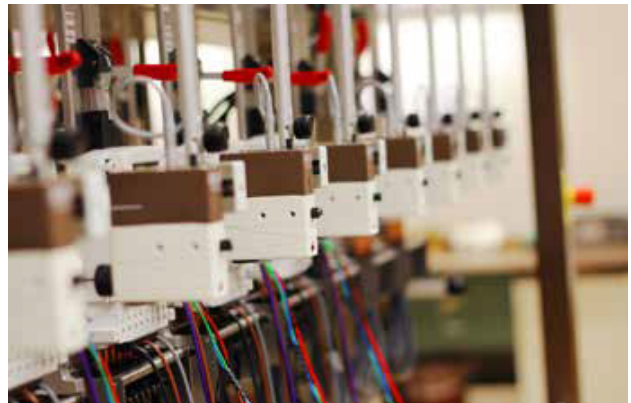
CKW Eichstelle E28 und Anlage
