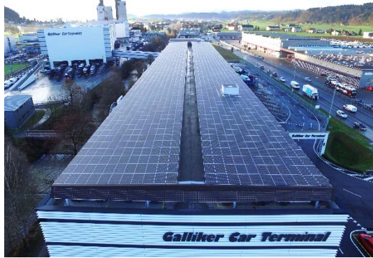
Die PV-Anlage deckt den Energiebedarf des Gebäudes ab und versorgt zudem 148 Elektroautos mit Strom.
