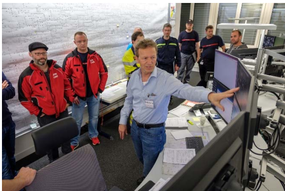
In der CKW-Netzleitstelle steuern und überwachen Spezialisten das Stromnetz und mehrere Kraftwerke.
