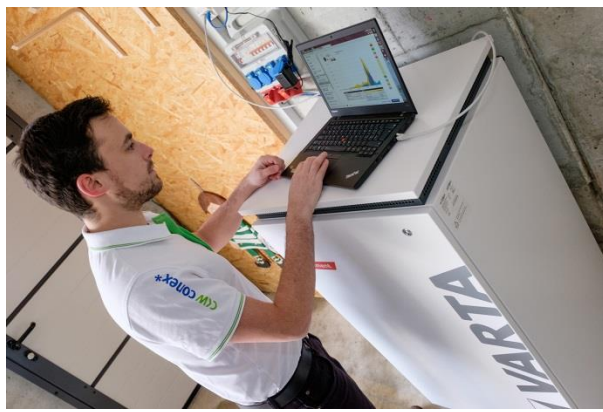
Damian Haas von der CKW Conex AG installiert einen Varta Element Batteriespeicher.
