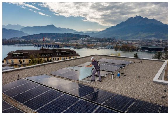
Die von CKW seit 2013 installierten Solaranlagen produzieren Strom für über 5'000 Haushalte.
