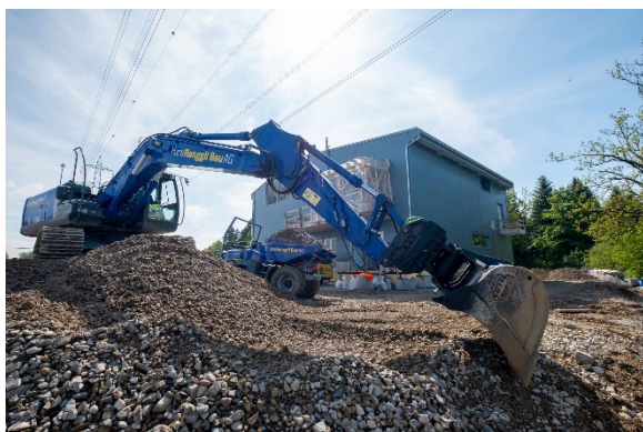
In Rothenburg baut CKW eine neue Unterstation. Sie wird ab Frühling 2020 die Stromversorgung in den Regionen Sempach, Rothenburg, Emmen und Littau stärken.
