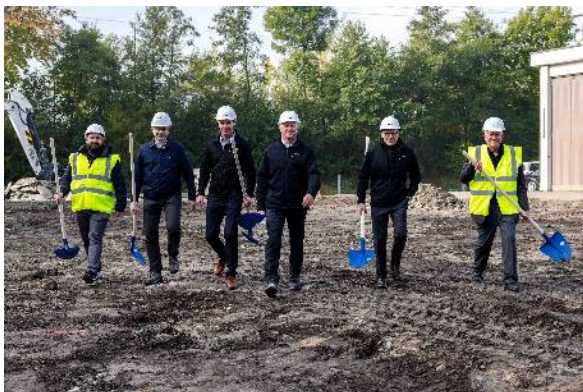
Sie schreiten zum Spatenstich: (v.l.) Severin Ruesch, Projektleiter mb-ingenieure, Patrick Wahl, Gemeinderat Risch/Rotkreuz, Adrian Bieri, Leiter Operations & Technology CKW Fiber Services, Martin Schwab, CEO CKW, Roberto Cresta, Vorsitzender Geschäftsleitung CKW Fiber Services und Markus Bühlmann, Inhaber mb-ingenieure.
