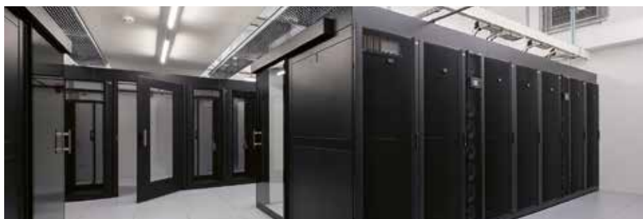
Effiziente Warmganginstallationen mit Zeilenkühlgeräten.
