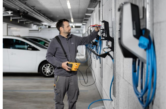
Das CKW-Segment Gebäudetechnik konnte den Umsatz im vergangenen Geschäftsjahr um 8 Prozent steigern. Massgeblich dazu beigetragen hat der Installationsbereich.
