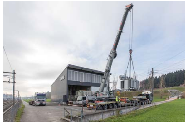
Der neu installierte 110-kV-Transformator ist das Herzstück der Unterstation Dierikon.
