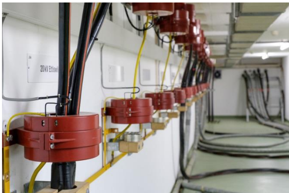
In den für Mittelspannung isolierten Kabeln fliesst der Strom von der Unterstation weiter zu den lokalen Trafostationen in der Region nördlich des Napfs.
